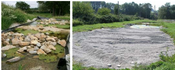
Σχήμα 3. Καταρράκτης δεξαμενών διατήρησης. Η σωστή εικόνα δείχνει το κρεβάτι από χαλίκι και άμμο.
